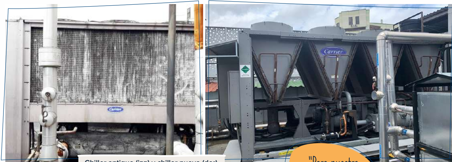
Chiller antiguo (izq) y chiller nuevo (der)
