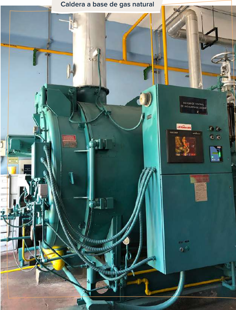
Caldera a base de gas natural
