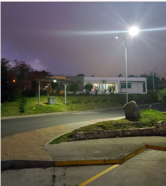
Postes solares con reflectores LED
