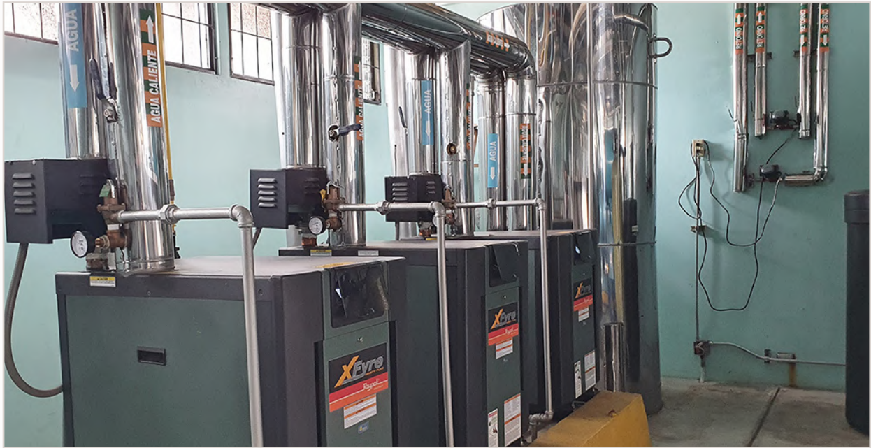
Calentadores de agua que funcionan con GLP
