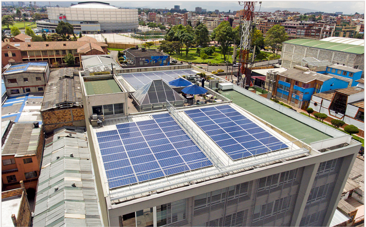
Paneles solares de Colmédica
