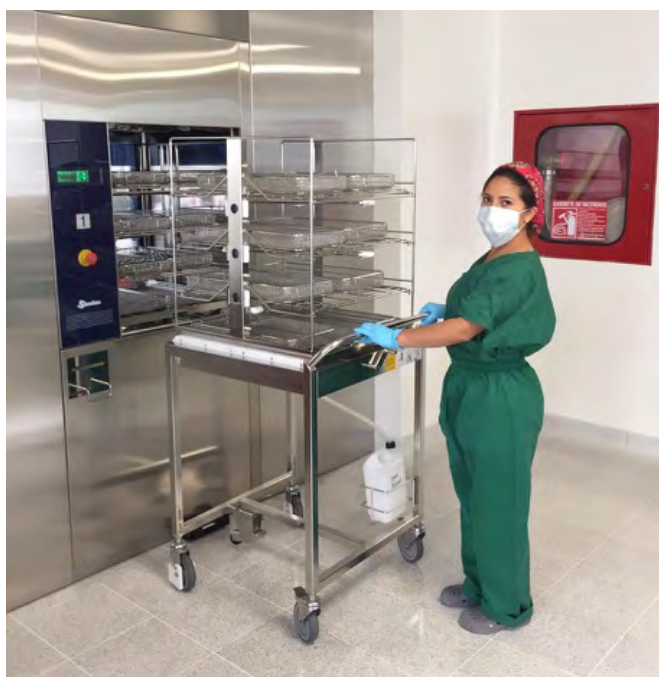
Una profesional de la salud utilizando en forma segura el esterilizador de peróxido de hidrógeno (foto: Hospital Departamental Universitario de Nariño, Colombia)
