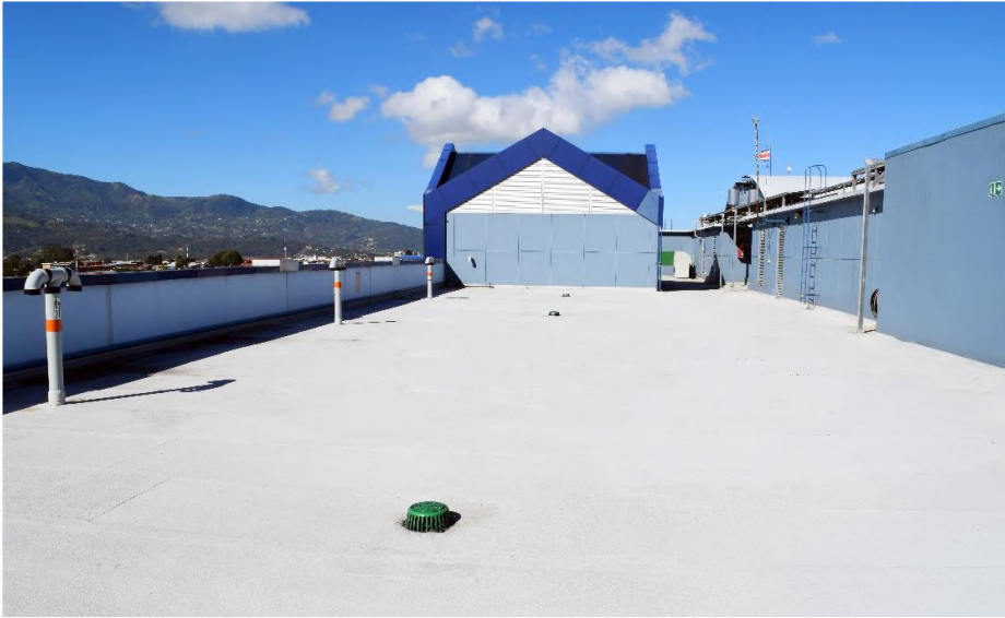
Captación de agua de lluvia en azoteas.
