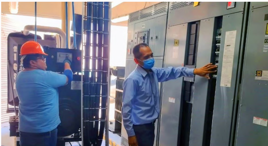
Planta de emergencia y tableros eléctricos
