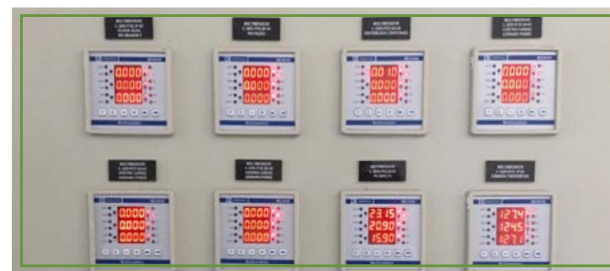
Medidores internos de energía eléctrica
