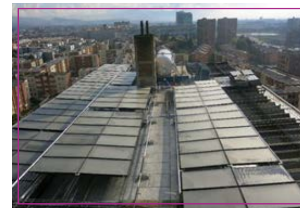
Nuevos colectores solares
