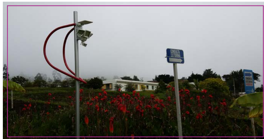
Equipo de iluminación externa alimentado con energía solar
