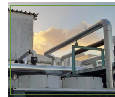
Modernización de la Central de Agua Helada (CAG)
