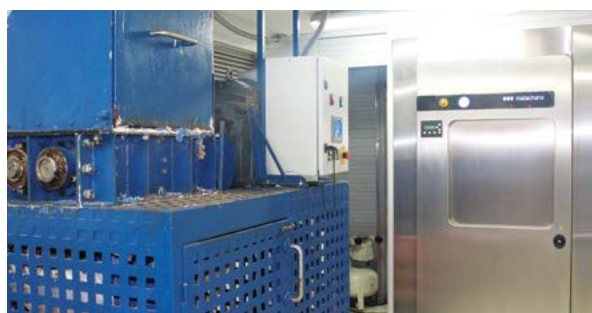
Equipos de trituración, compresión y descalcificación
