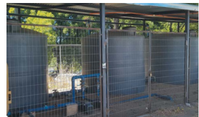
Estanques de 10.000 litros
