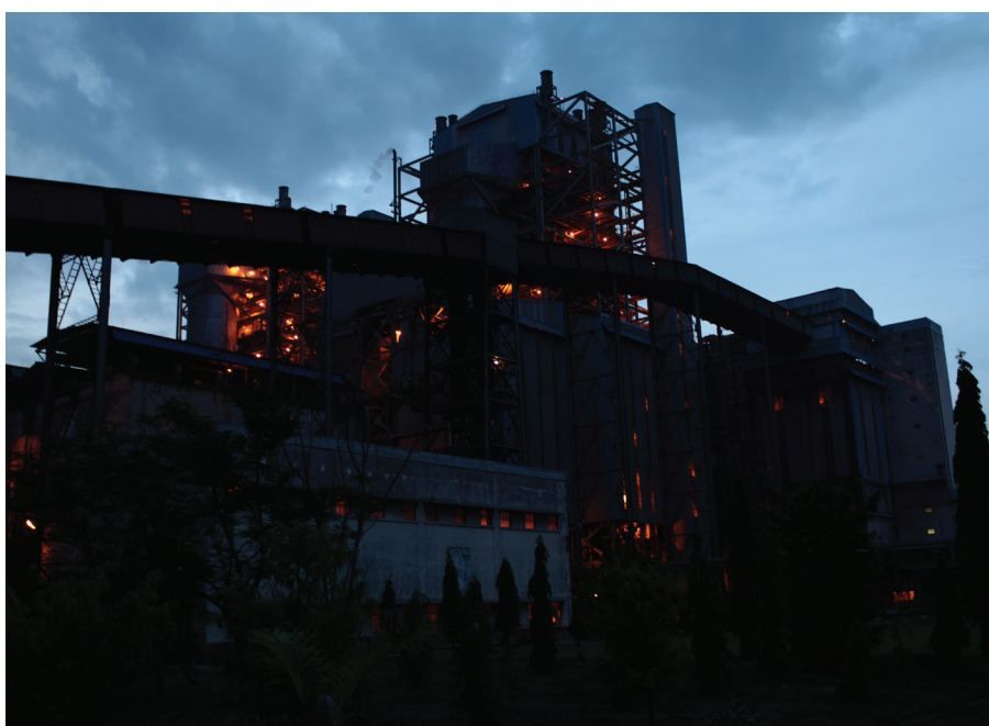
Sector de calderas de la central térmica de Neyveli, estado de Tamil Nadu, al atardecer © Amirtharaj Stephen
